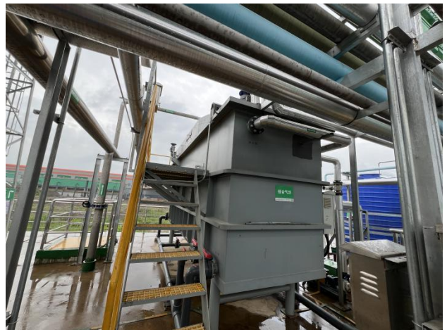
厂区污水处理设施
