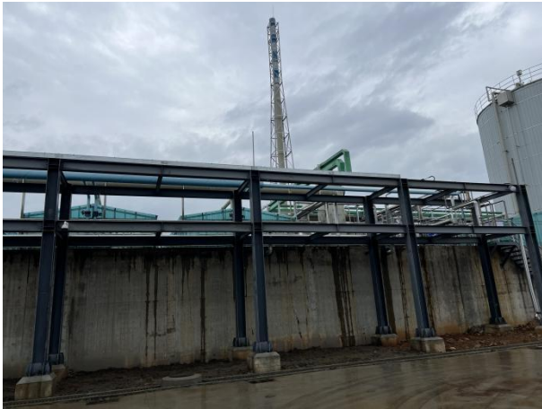
厂区污水处理设施
