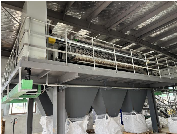
污泥压滤设施
